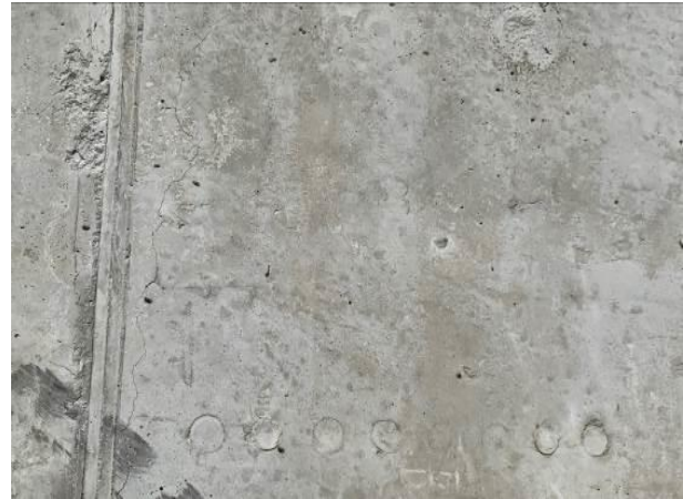
Рис. 3. Тріщини на поверхні бетону
